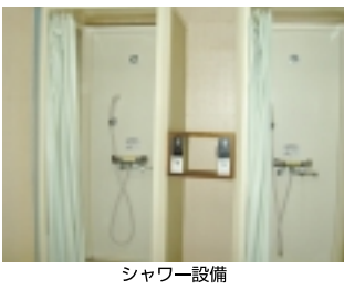
シャワー設備
